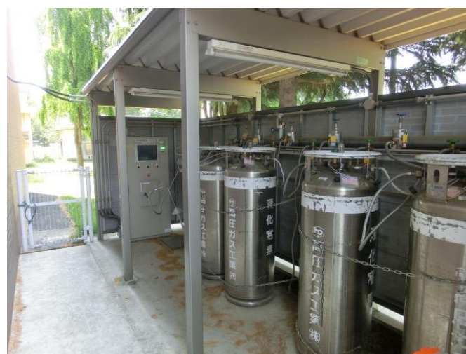
農学部 液化窒素汲み出し施設
