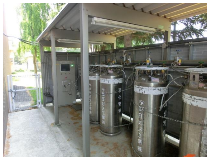
農学部 液化窒素汲み出し施設
