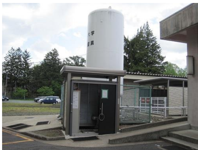
理工学部 液化窒素汲み出し施設
